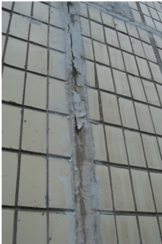
Рисунок 3 — Состояние швов через три года после ремонта
